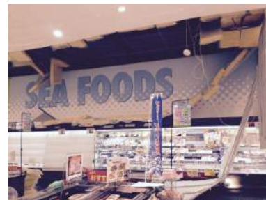
被害を受けた生協くまもとコープ春日店 ※CO・OPnavi 3月号で紹介されたばかりでした。
